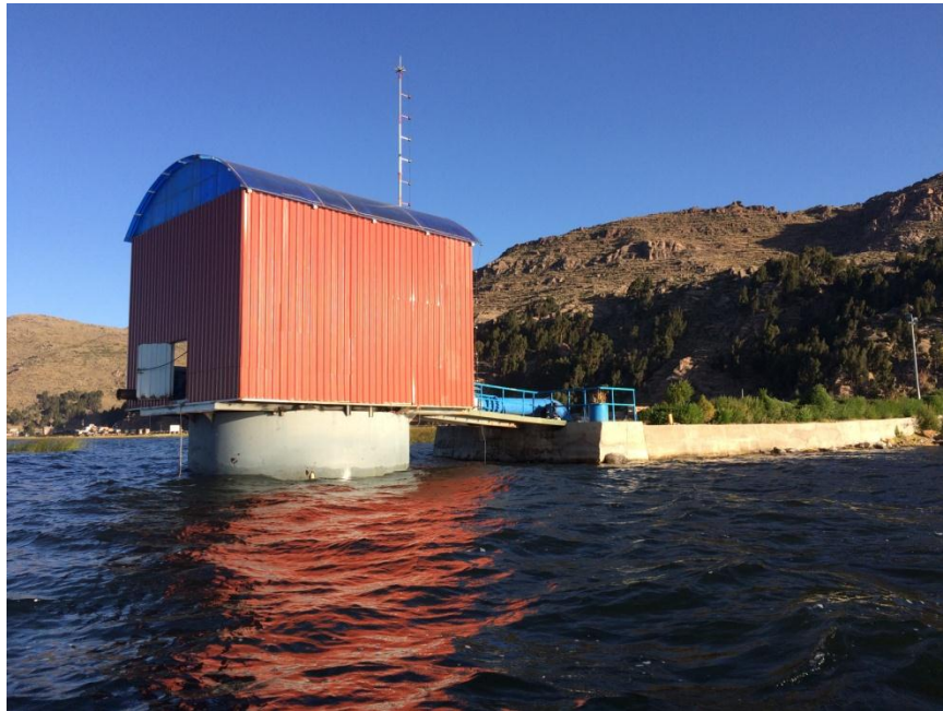
Figura 15: Planta de bombeo de agua potable.
